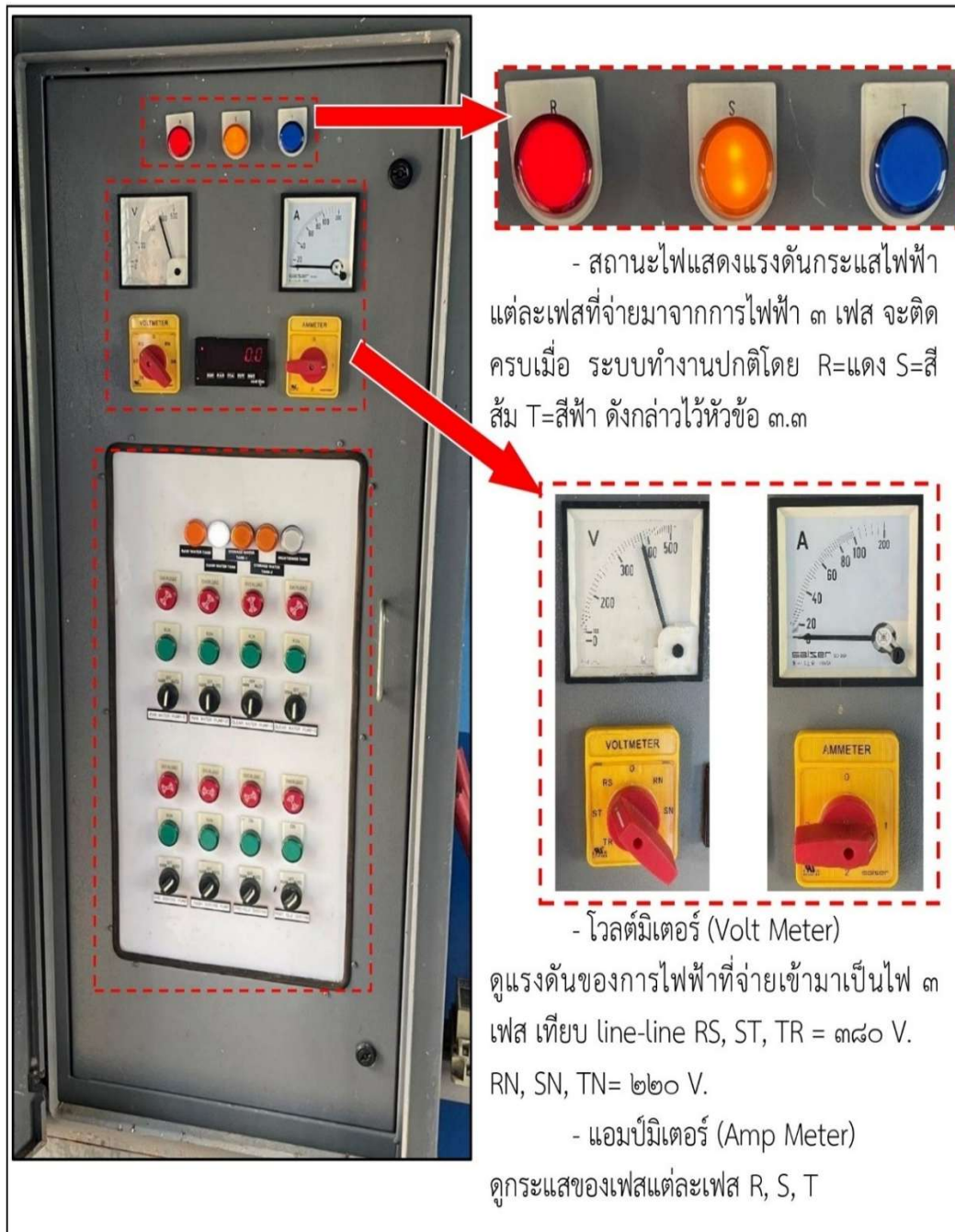
ภาพที่ ๑๔ ตู้คอนโทรล (Electrical control) สถานะไฟแสดงหน้าตู้
